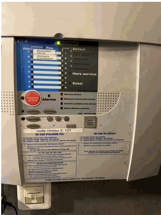
état de la centrale a mon départ
